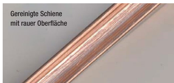
Abb.: geschädigte Schiene nach Bürsteneinsatz
